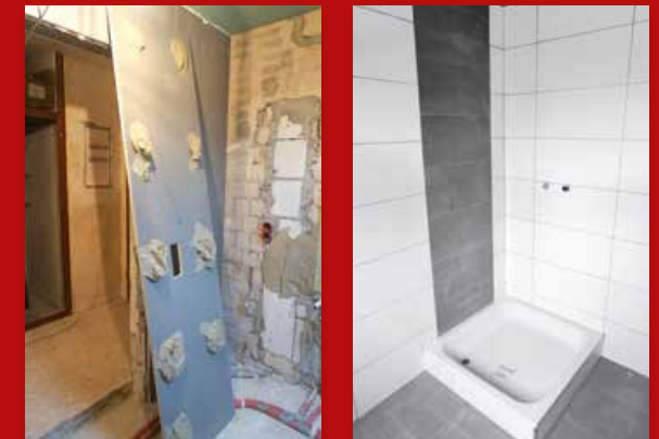
Oststraße 16 – Dusche vorher/nachher
